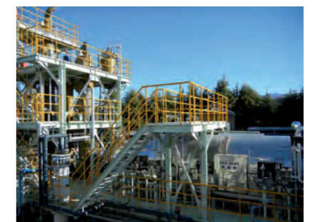
温室効果ガスの除害設備
