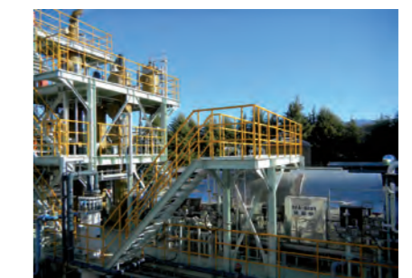
温室効果ガスの除害設備
