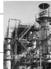
トリクロロールエチレン製造設備
