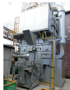
環境汚染物質の除害設備
