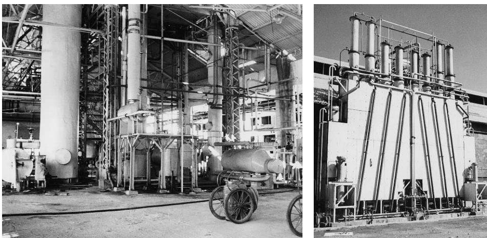
シクロヘキサノン製造設備
