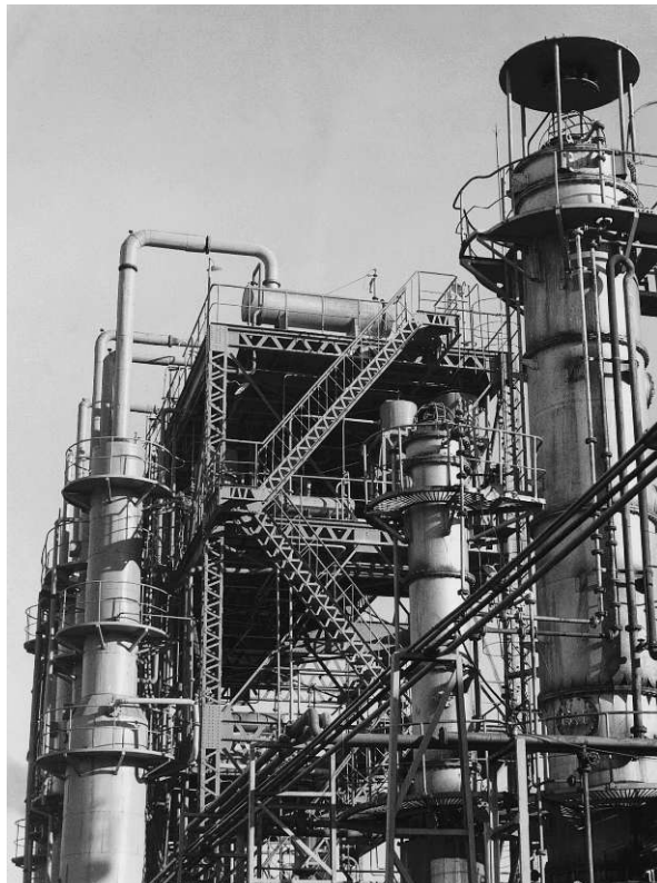
トリクロールエチレン製造設備
