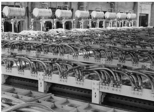
食塩電解設備
