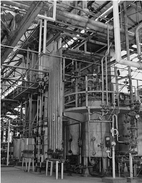
六フッ化硫黄製造設備
