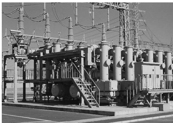
六フッ化硫黄を使用した変電所
