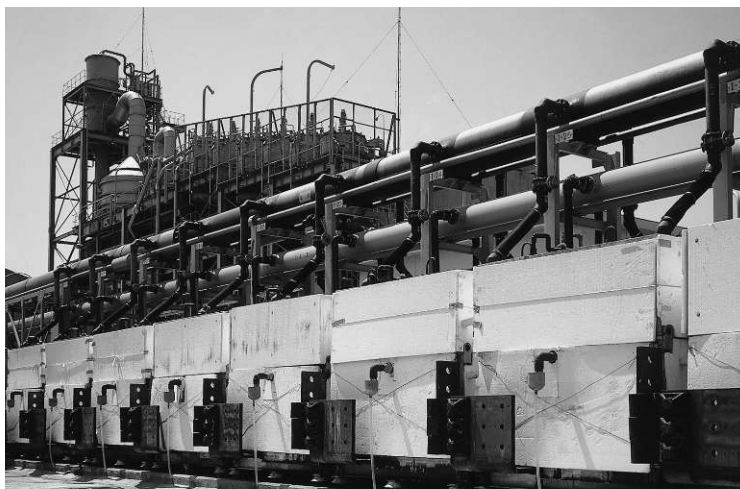
水島工場隔膜電解設備
